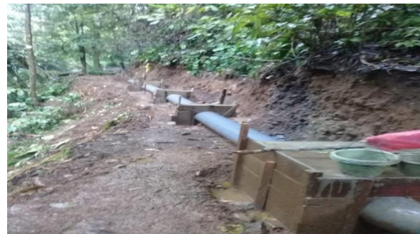
Gambar 10. Saluran pembawa ke rumah turbin
