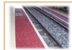
Lantai sudah berganti dengan keramik
