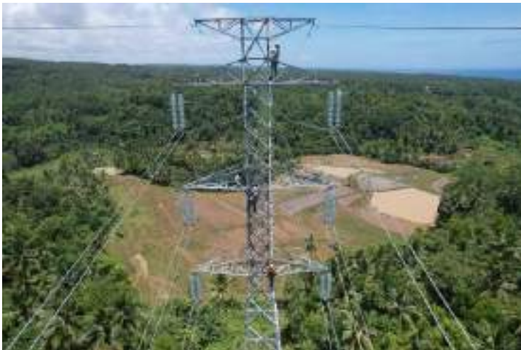
Gambar 4.2. SUTT Kapasitas 150 kV Gambar (Sumber: RRI, 2022)
